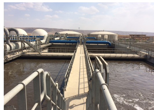
Estación depuradora de aguas residuales de New Cairo. Egipto.
